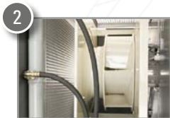
Turbine de ventilation
