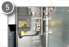
Armoire électrique VSD
